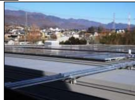
甲斐センター 太陽光発電設備
